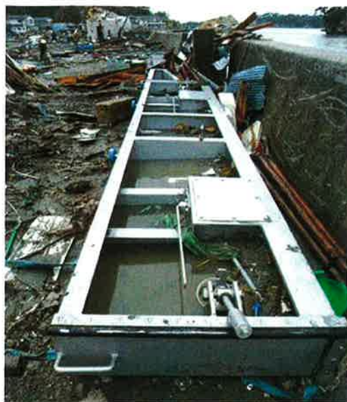
津波により損壊した防潮堤門扉
