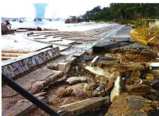
桂島海水浴場の被災状況
