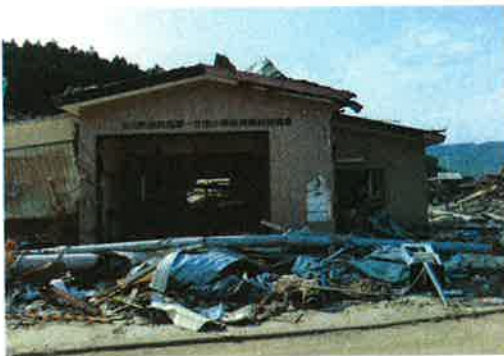
震災後 26施設中22施設が全壊 資機材格納庫
